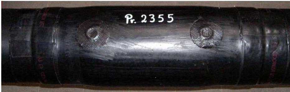
Bild 4: Muffenbereich von KMR 2355 in 12-Uhrlage vor der Prüfung
