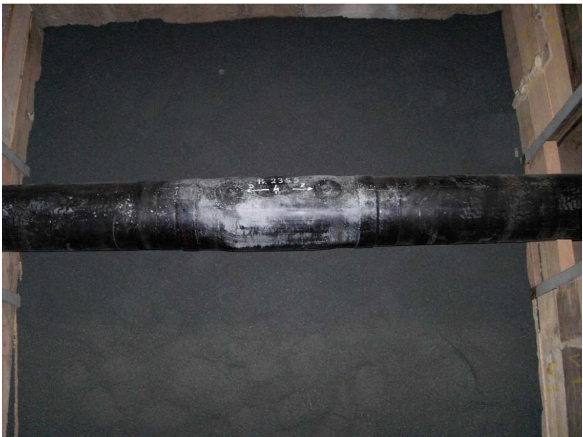
Bild 5: Muffenbereich von KMR 2355 in 12-Uhrlage im Sandkasten vor der Prüfung
